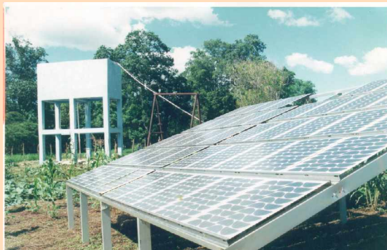
Acueducto alimentado con energía solar.
