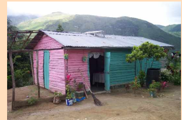
Panel solar instalado en una vivienda rural.
